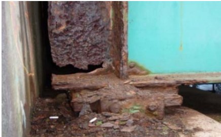
写真-1 補修前の桁端腐食の状況例 2)
