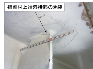
写真-1 溶接部のき裂発生状況
