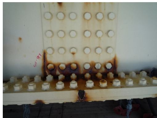
写真-1 添接板の腐食状況
