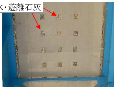
写真 3 床版下面状況(0304)
