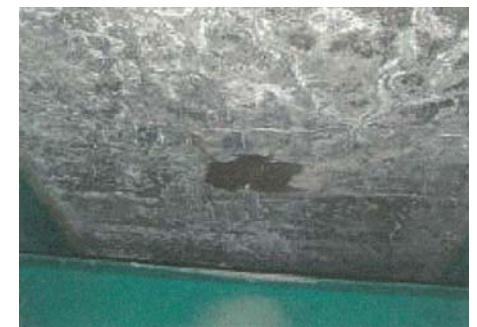
図-4. RC 床版下面損傷図
