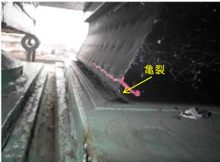
写真-1 損傷状況
