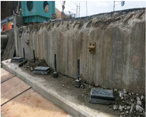
写真-1 長期間供用されたパッド型ゴム支承
