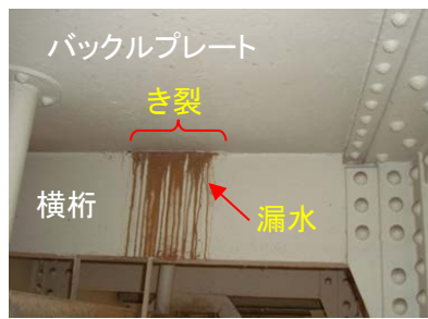
図 2 取付け部の変状事例
