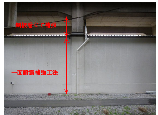
写真 1 建物が接した高架橋柱
