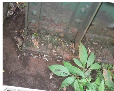
図-3 支承部の土砂堆積例
