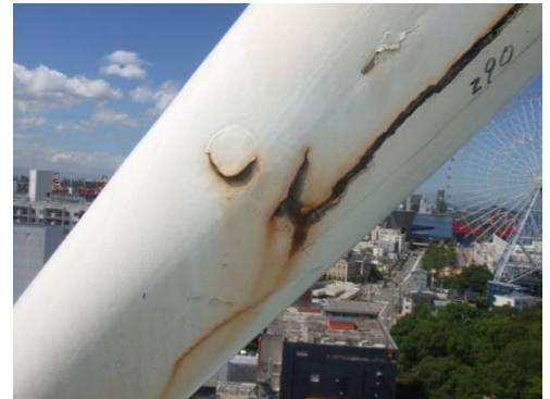
写真-1 ケーブル被覆材の割れ
