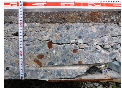
写真1 RC床版内部に発生した
