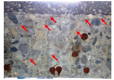
写真3 微細ひび割れの状況
