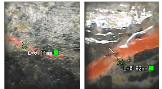
写真5 ひび割れ幅の測定結果
