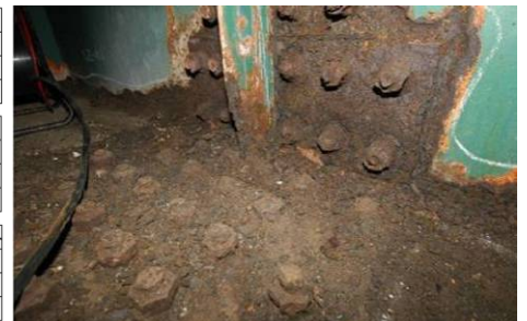
写真-2 添接部腐食状況
