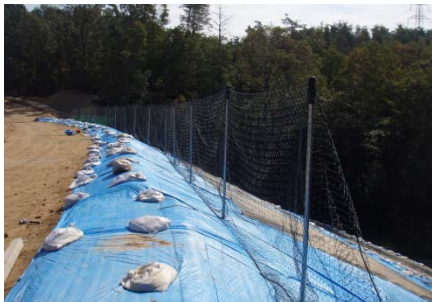
写真-4 シカ侵入防止柵
