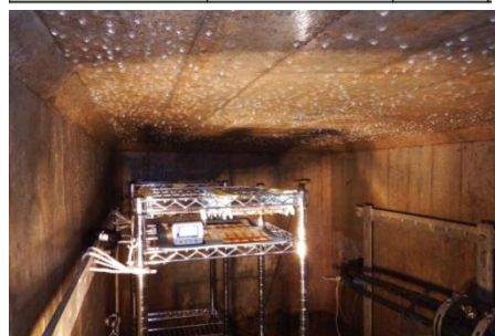
写真 1 温湿度ロガーの設置
