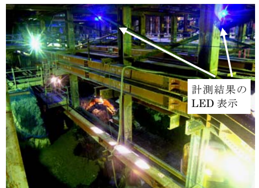
写真-2 傾斜計計測のLED表示状況
