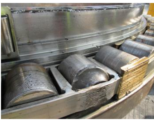
写真-2 ロールラ損傷
