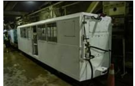
写真-1 TBM 後続台車水冷式冷却設備
