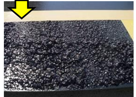
図2 瀝青質塗装の剥離状況
