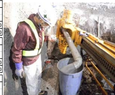
写真1 湧水発生状況
