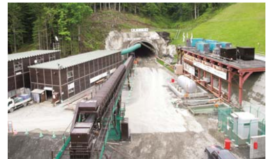
写真-1 坑口部坑外ベルトコンベア
