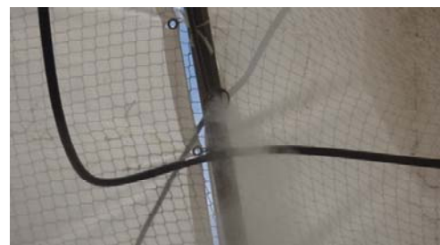
写真-2 ミストノズルの吹出し状況
