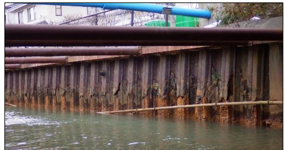
写真-1 鋼矢板の腐食事例
