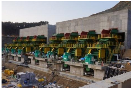
写真－1 8基の破碎設備 (破碎能力 1,000t/h・基)
