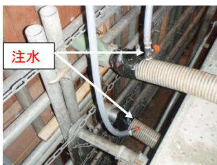
写真-1 クーリング管接続部
