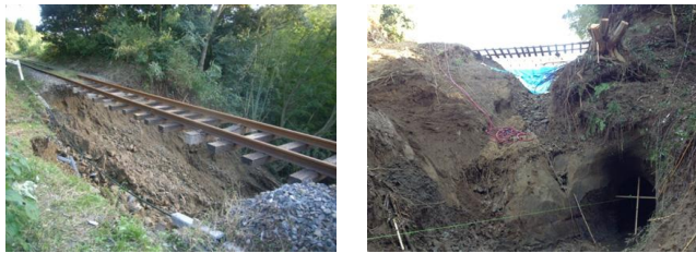
図 1. 土砂崩壊状況
