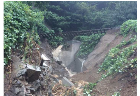
写真-1 被災状況
