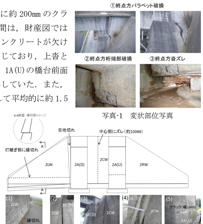
図-2 被災状況概要(終点方ウィング・もたれ壁)
