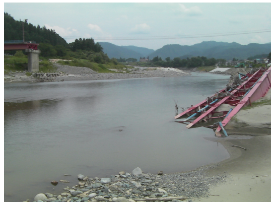
写真-1 2011.7 新潟・福島豪雨による流橋被害事例
