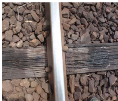
写真-2 表面に劣化を生じたまくらぎ
