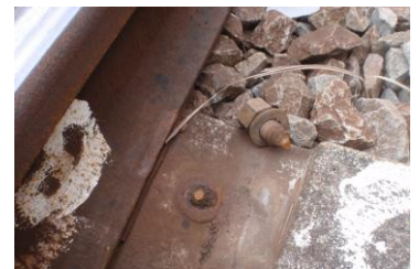
図-1 PC ボルト折損
