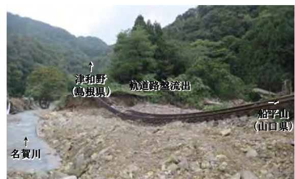
写真-1 被災状況
