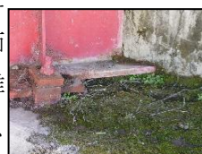
写真3 橋座面の土砂堆積の1例
