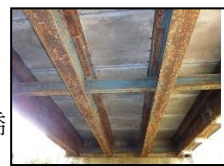
写真8 主桁の腐食の1例
