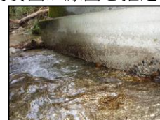
写真4 下部工前面の河床洗掘の1例
