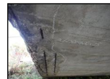
写真7 上部工の部分損傷の1例
