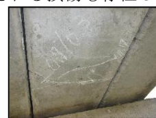
写真5 過積載荷重によるひび割れの1例
