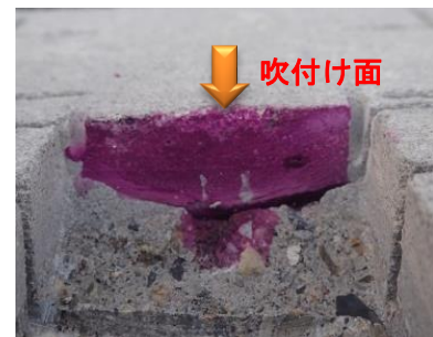
写真-2 材齢10年供試体中性化状況
