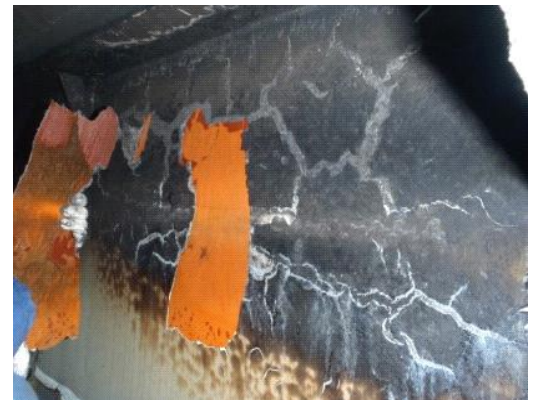
写真－2 主桁腹板の塗膜状況
