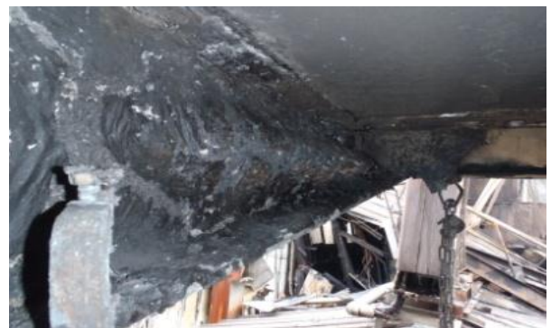
写真-7 耐火塗料発泡状況
