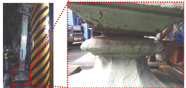
写真-2 傾斜した鋼橋脚と橋脚下端ピボット支承
