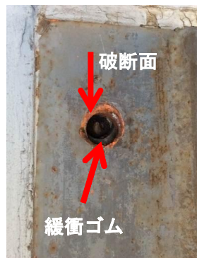
図-2 破断箇所状況
