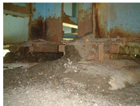
写真1 土砂等が堆積した支承の設置環境例
