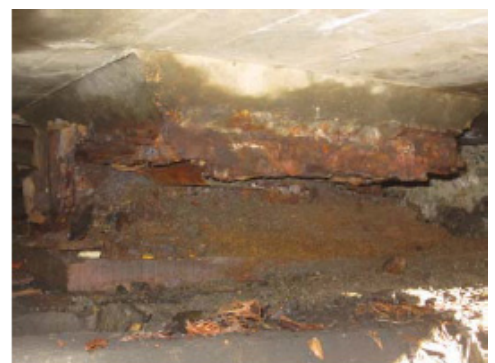
写真－1 P2 支承装置の腐食状況
