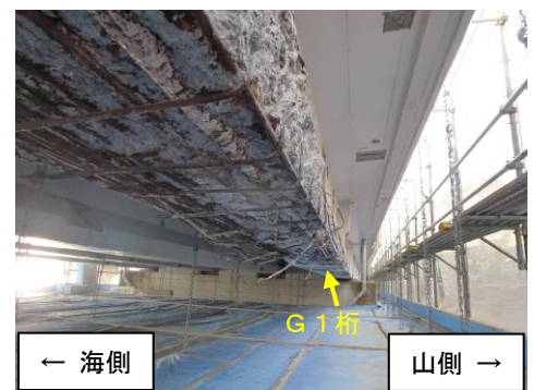
写真-1 PC 鋼材破断状況
