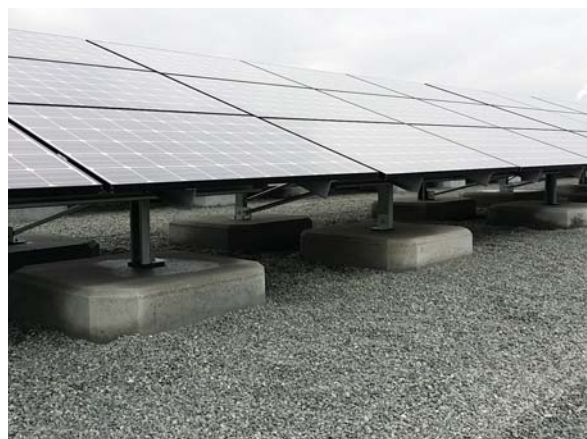
図 1 ソーラーパネル基礎ブロック
