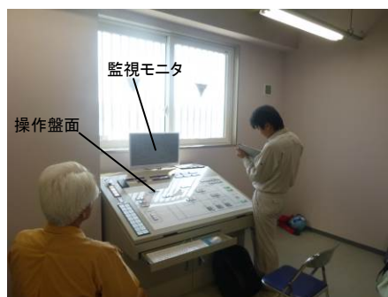
(b) 監視操作盤（機側室 3 階）
