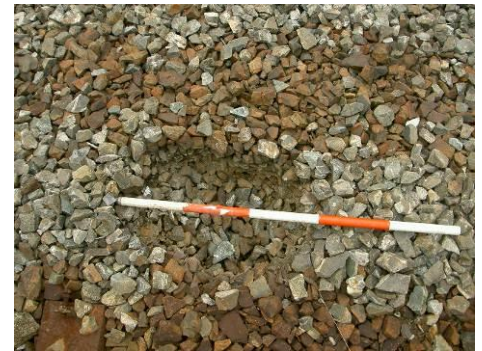
写真-1 地表部の局所的な沈下
