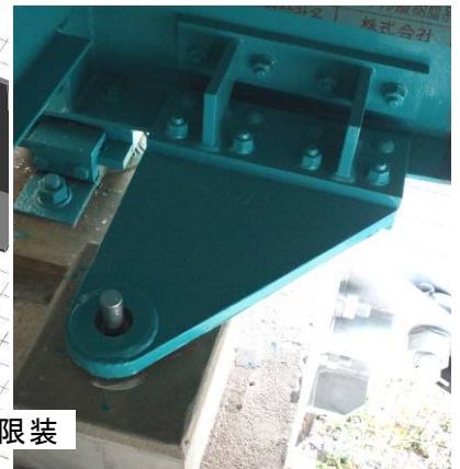
写真-4 変位制限装置
