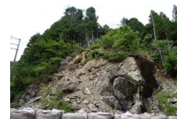
写真2 正面(半崩落部) 写真
