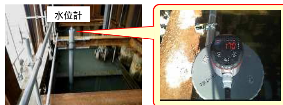
図-4 機器設置状況
