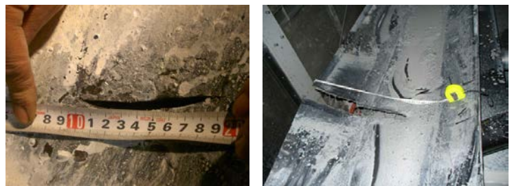
写真-1 連続ベルトコンベア損傷例
