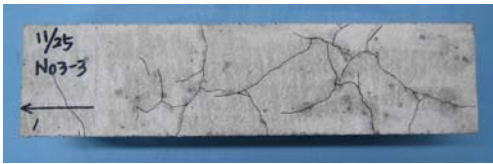
写真 1 ひび割れ状況（配合 NO.3，材齢 3 ヶ月）
