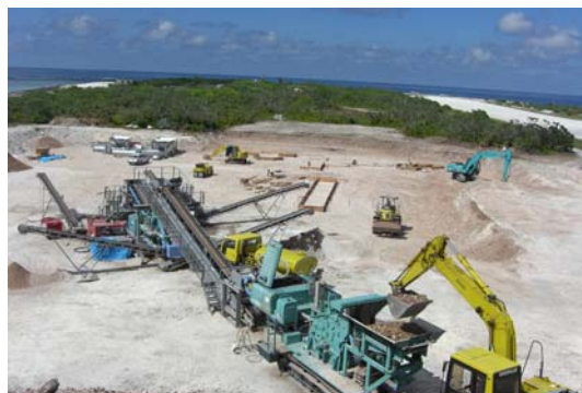
写真-2 砕石プラント
