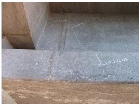
図 5 ひび割れ発生状況
